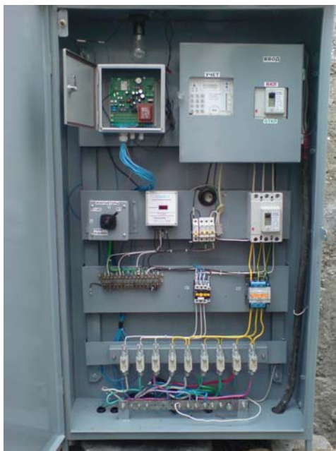
Рис. 2 Пункт включения - шкаф И-710 с установленным терминалом
