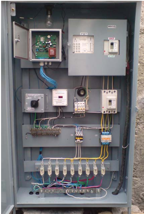
Рис. 7. Пункт включения — шкаф И-710 с установленным терминалом
